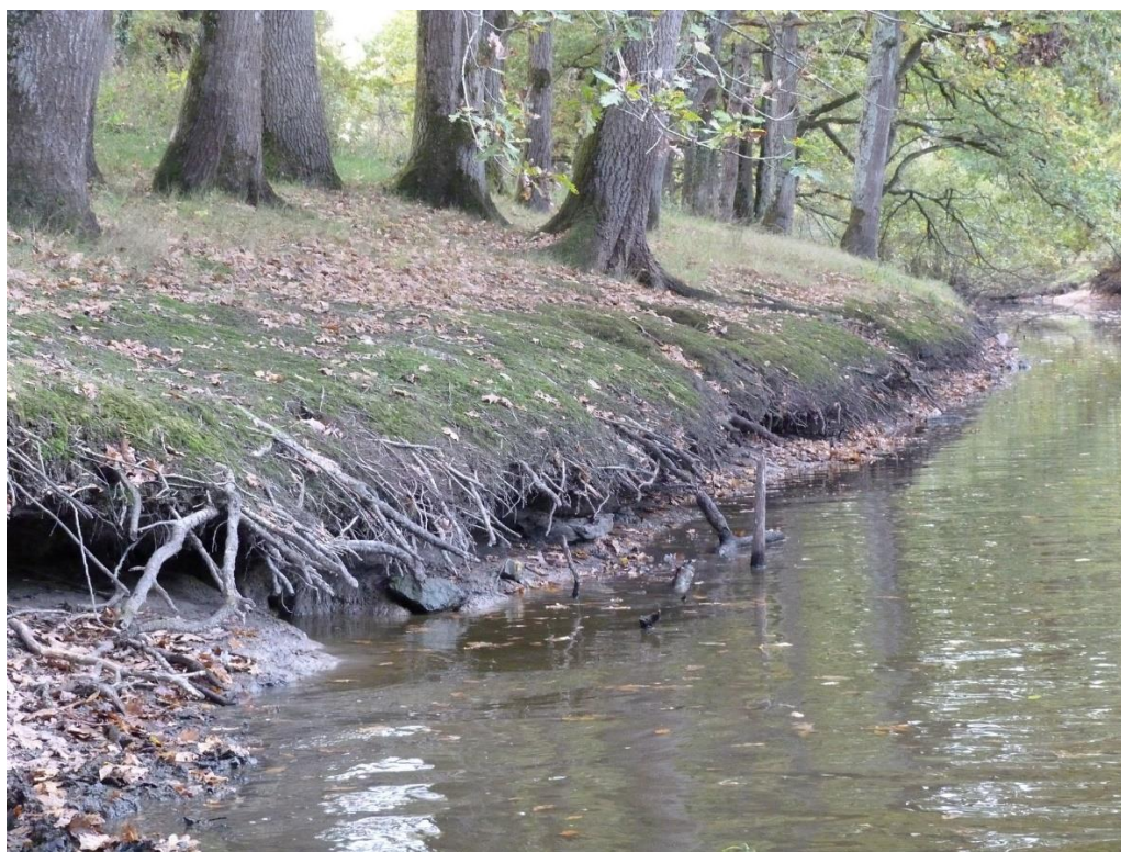
Figure 10 : Erosion sur le canal de l'Etier
