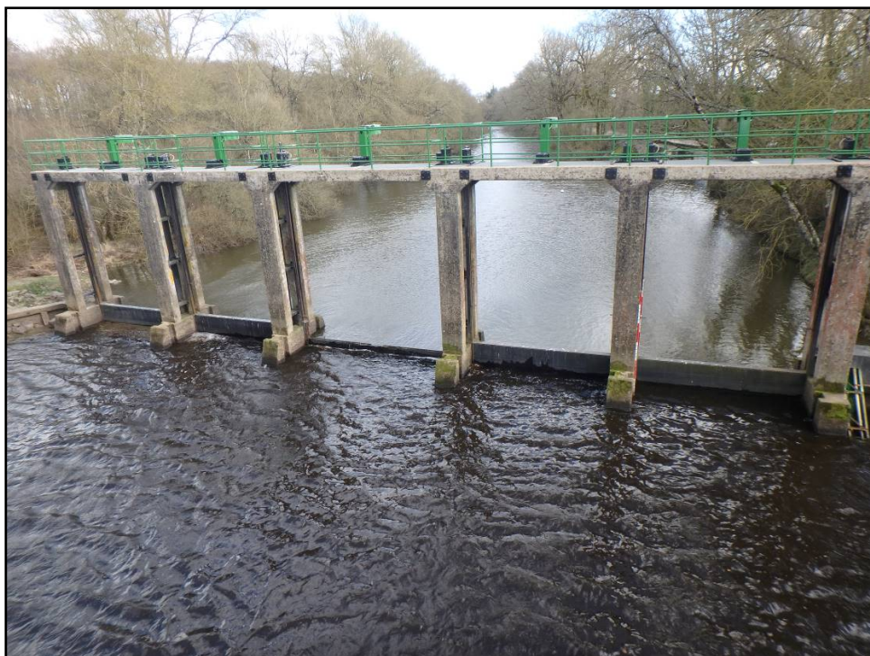
Figure 17 : Vue aval des 5 vannes de l'ouvrage de Bouaye (FISH-PASS)
