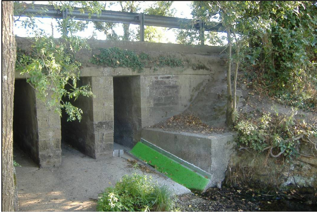
Figure 24 : Aval du seuil de Maison Blanche hors surverse (FISH-PASS)
