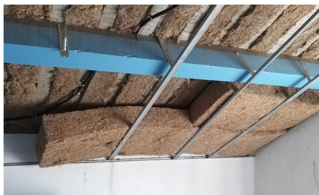
> Mise en place de l'isolation en paille de riz dans le bâtiment du phare
